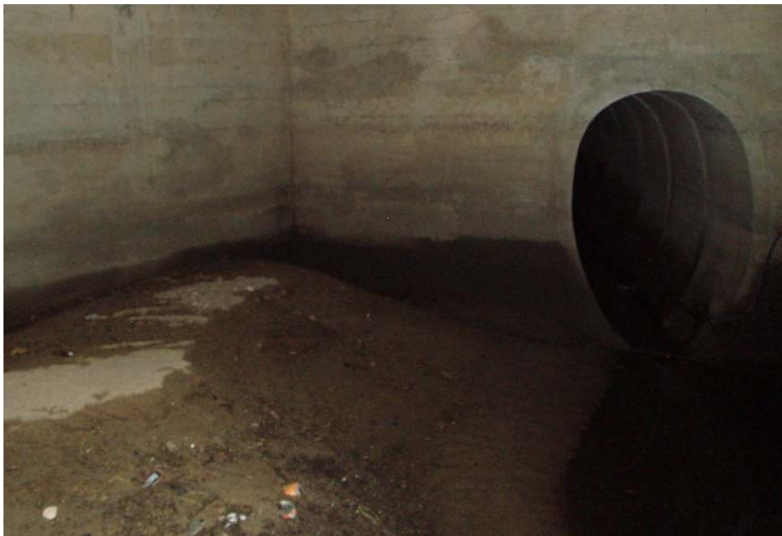
Photo 52 : Fosse à sable le 11/06/2009
